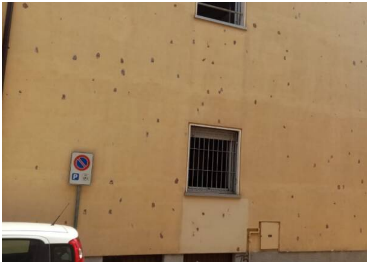
La facciata del Municipio di Uboldo danneggiata dalla grandine
